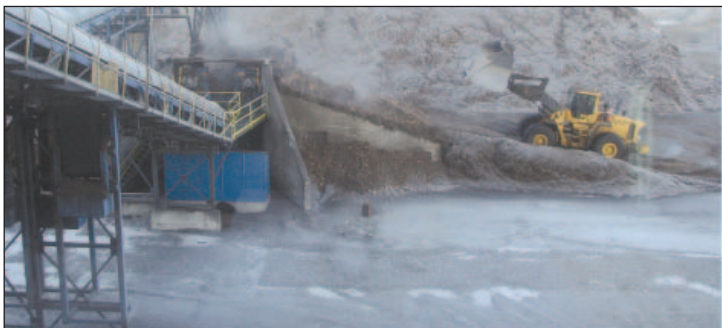
Un tracteur chargeur alimente de biomasse un des deux systèmes de convoyeur d'alimentation de la bouilloire.
